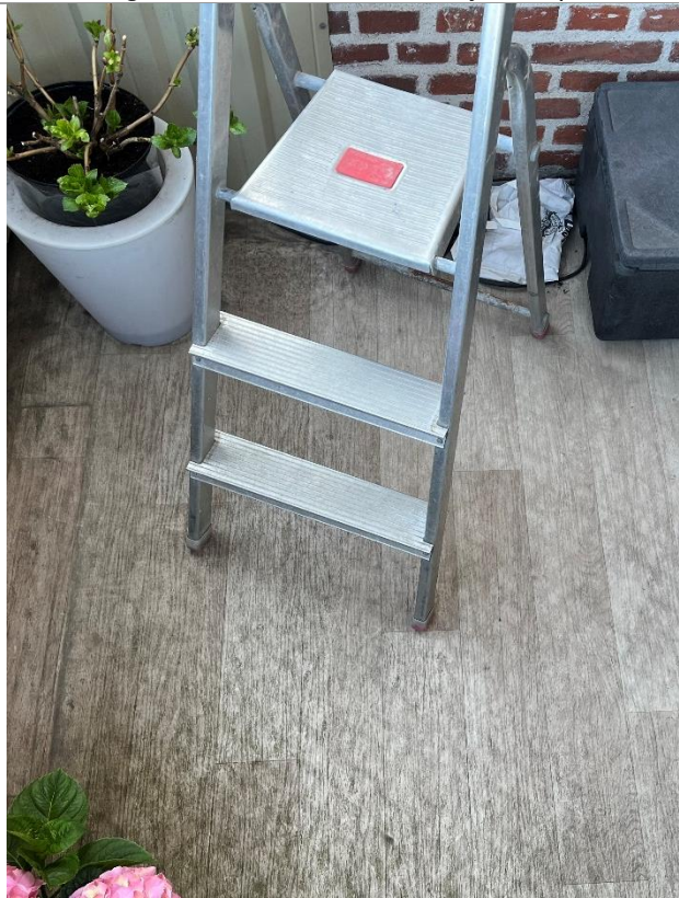
Foto 15: På overside var der udlagt en linoleumsbelægning oven på aluminiumsdørkpladen. Besigtigelse af bærende indstøbningsdele blev udført fra undersiden af den overliggende altan (4. TH.).
