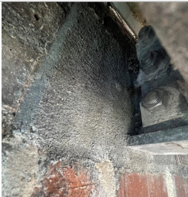
Foto 5: Bærebeslag og cementmørtel fremstår også her uden synlige tegn på korrosion/nedbrydning.
