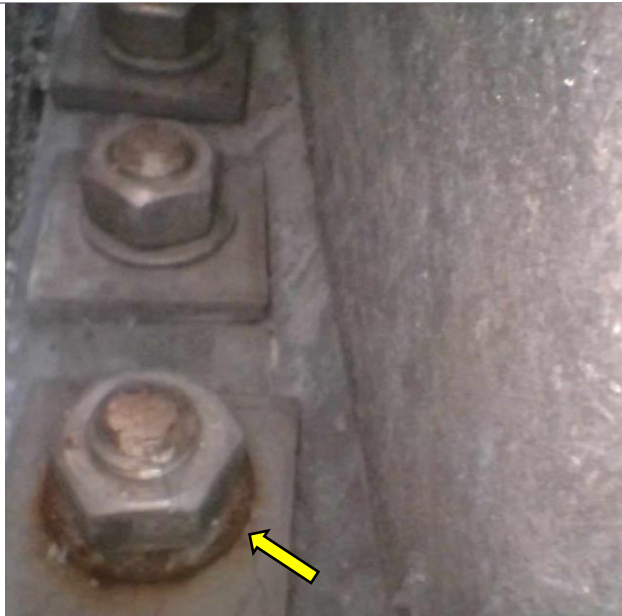
Foto 14: Foto taget med endoskop af beslag i område, hvor bærebeslagene ikke er synlige, fordi inddækningspladen på undersiden, er skubbet helt op mod facaden. På en enkelt spændeskive ses overfladekorrosion. Ingen korrosion af bolte, gevind eller møtrikker.
