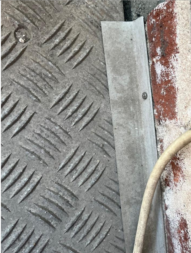
Foto 11: På overside af denne altan, var aluminiumsdørkpladen, som er udlagt på de bærende RHS- og IPE-profiler, synlig. Pladen samt øvrige ståldele (skruer, bolte og spændeskiver) fremstår generelt uden spor af rust.
